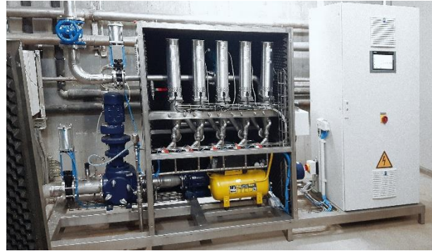
Bild 4: 5 kW Anlage Klärwerk Forli (2019)
