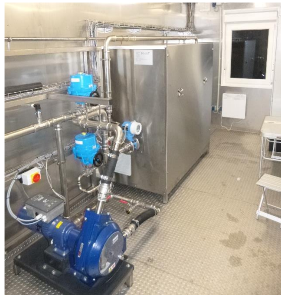
Bild 5: 5 kW Anlage Klärwerk Mainz (2019)
